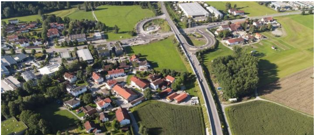
Baufeld 1 mit der noch im Umbau befindlichen Anschlussstelle St 2078 // Foto: STBARO / Schellmoser
