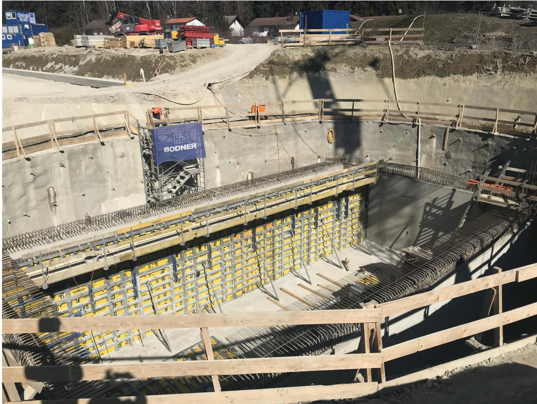
Aufnahme vom März 2022: Bau des unterirdischen Regenrückhaltebeckens für die Tieflage Großholzstraße (Copyright: Staatliches Bauamt)
